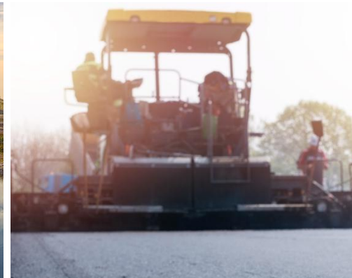
Fix it First Reparación Primero
